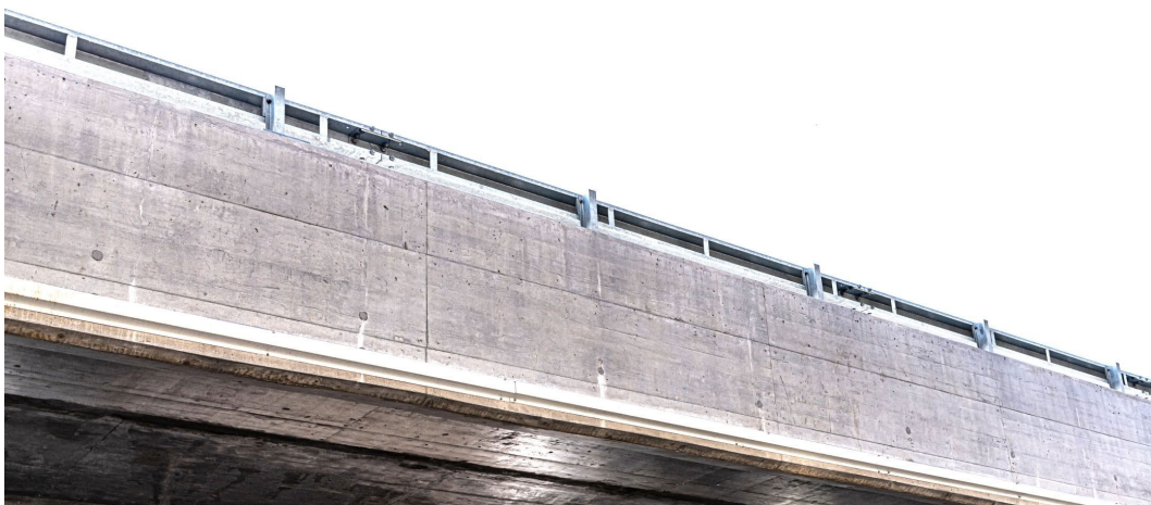
Abb. 6.13 Aussenseite der Brüstung auf der Bergseite mit Rissen und Ausblühungen. Foto ASTRA vom 28.03.2022.
