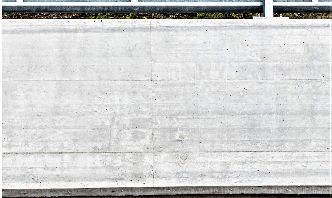
Abb. 6.3 Aussenseite der Brüstung auf der Seeseite. Foto ASTRA vom 28.03.2022.
