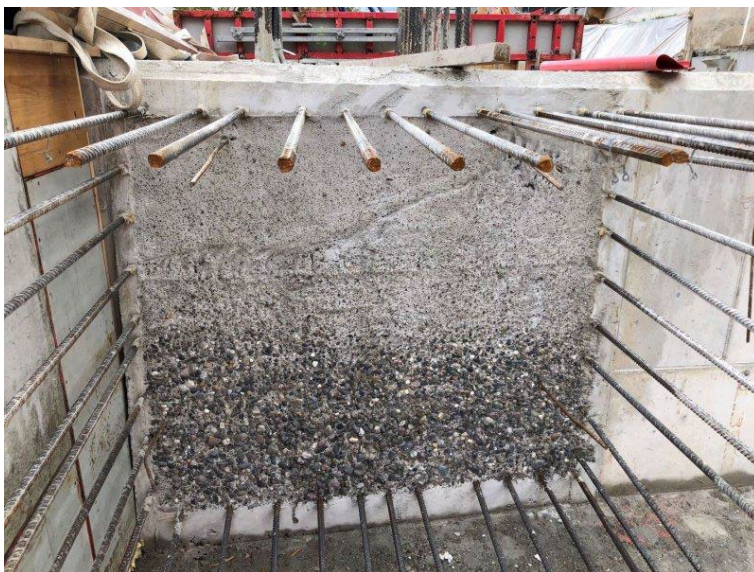
Abb. 2.5 Starke Entmischung bei einem Querträger, sichtbar geworden nach dem Aufrauen der Anschlussfläche zum Bankett. Foto ASTRA.
