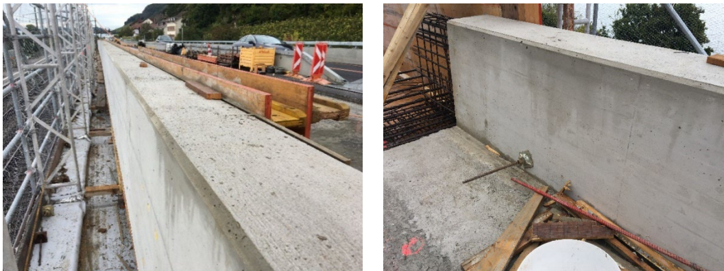
Abb. 6.1 Erscheinung der Betonoberfläche der südseitigen Brüstung nach dem Ausschalen. Fotos F. Hunkeler vom 04.10.2021.
